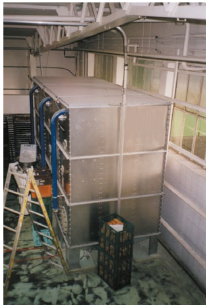
Mehlsilo mit Filtertuchabschluss
